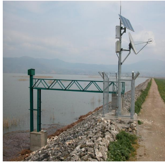
Resim 2 DSİ Uzaktan Algılamalı Akım Gözlem İstasyonu (AGİ)
